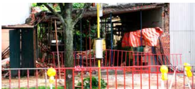
Beeld van een tijdje geleden: de restanten van een elektriciteitscabine in ons land na een vlamboog.
